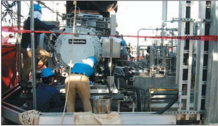
Montage und Inbetriebnahme dieser komplett vormontierten Einheiten ist wesentlich vereinfacht. Diese Pumpanlagen arbeiten in einem Exxon-Ölfeld im Tschad und fördern dort Multiphasenmischungen aus Öl, Gas und Wasser in variierenden Mengen.
